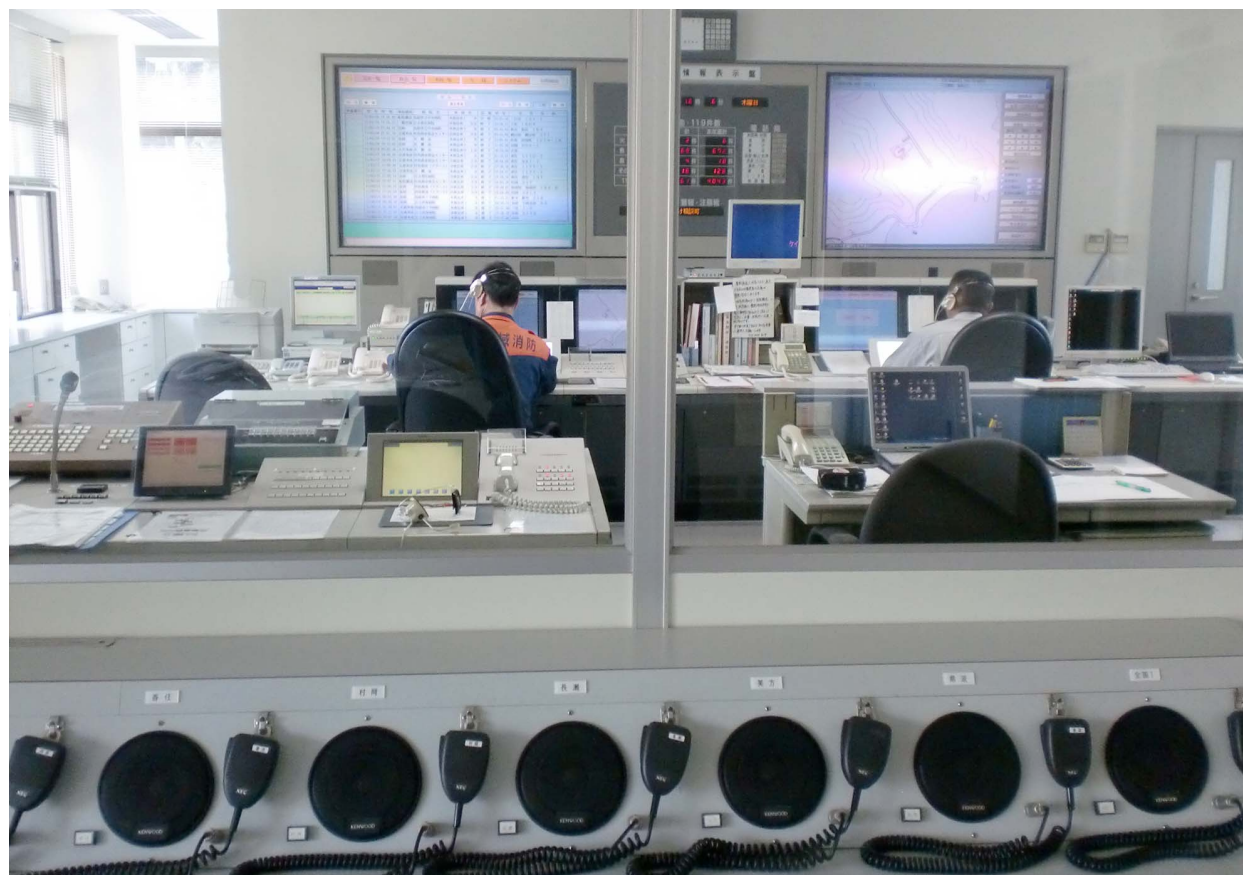
消防緊急通信指令システム
